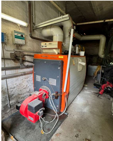
072g Apartmenthaus, alte Ölheizung
