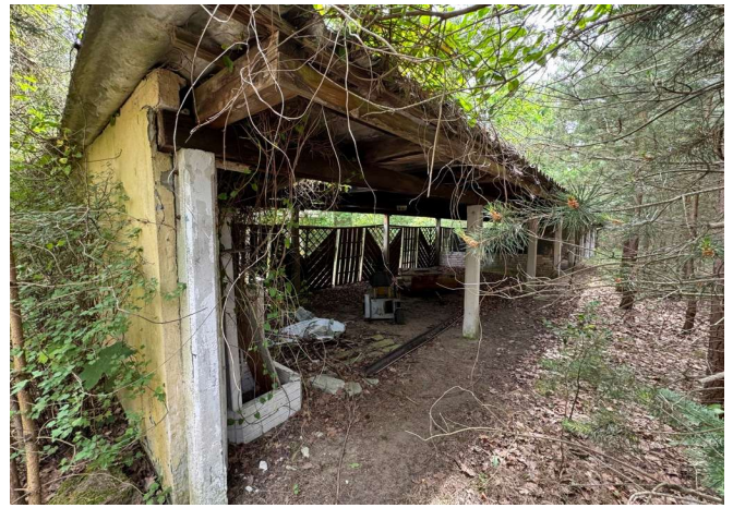
075a ehemalige Garagen, Dach undicht
